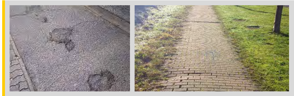
Abbildung 41: Gehwegschäden entlang der L 326 in Ulzburg Süd und im Abschnitt Wilstedter Str.–Elfenhagen
